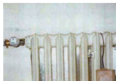
Рис. 2 Радиатор с установленным термостатом HERZ.
